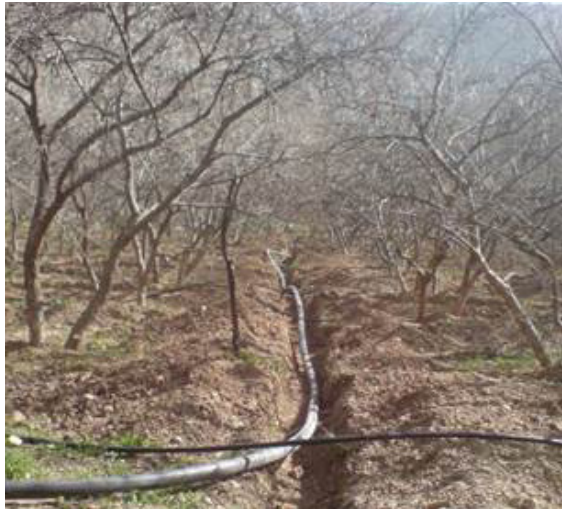
تصویر ۱-۲- باغ درجه دو انار که در آن عملیات اصلاحی در دست انجام است
